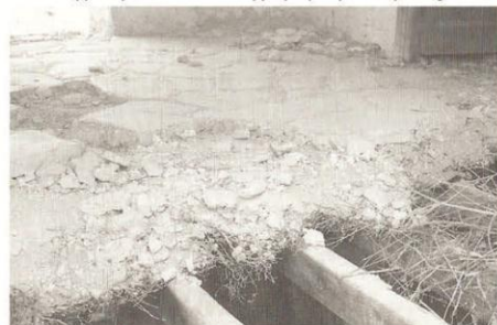
Φωτογραφία από υποχώρηση εδάφους
